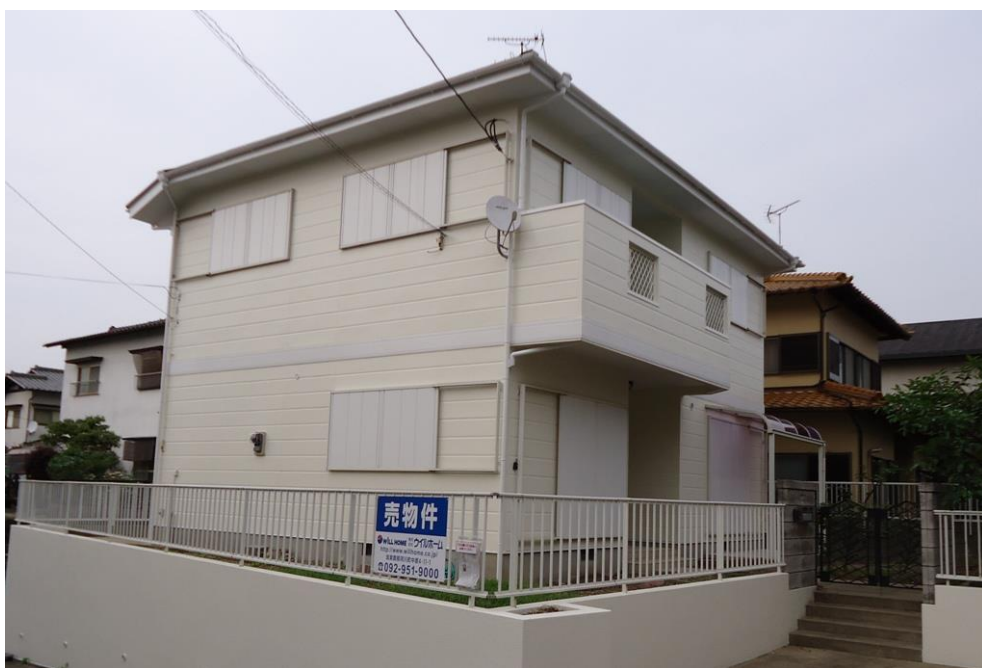
2. 塗装完成後 塗料はクリーンマイルドウレタン使用。2012年6月撮影
